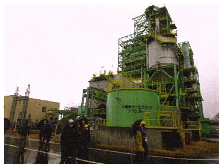
燃焼ボイラー
